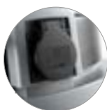
Salida de potencia para herramienta eléctrica
